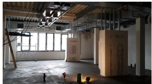
Bild 5 – Installation im Praktikum 1. OG
